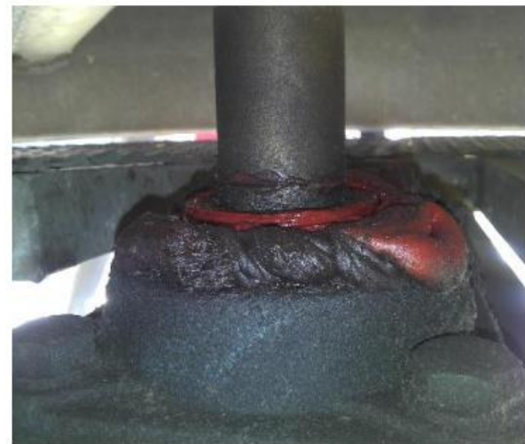
Fig. Soporte de fundición con exceso de lubricante, el sello dejó de funcionar, el rodamiento está comprometido y próximo a la falla.
